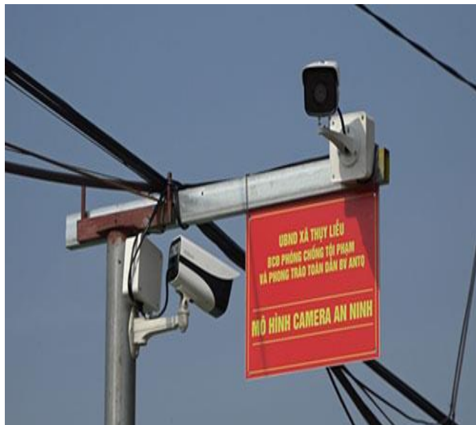
Hệ thống camera giám sát được lắp đặt tại cấp xã
